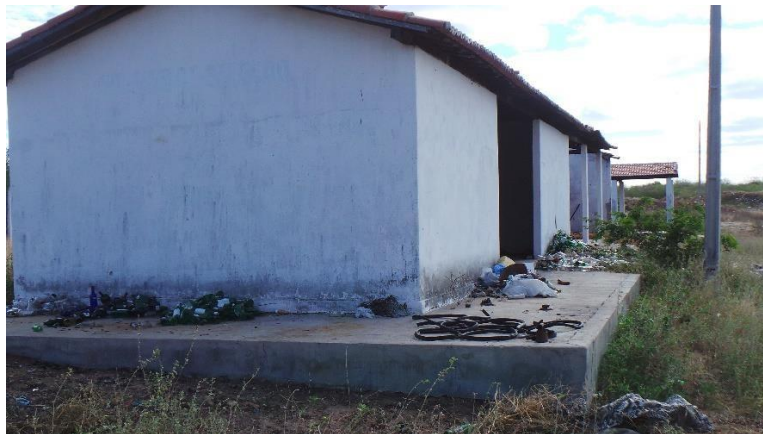
Figura 19. Espaço para triagem e armazenamento de resíduos recicláveis em São José do Sabugi – PB.
